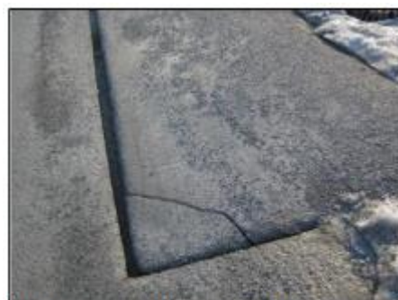
Uriktig utført asfaltskjøt uten fortanning
